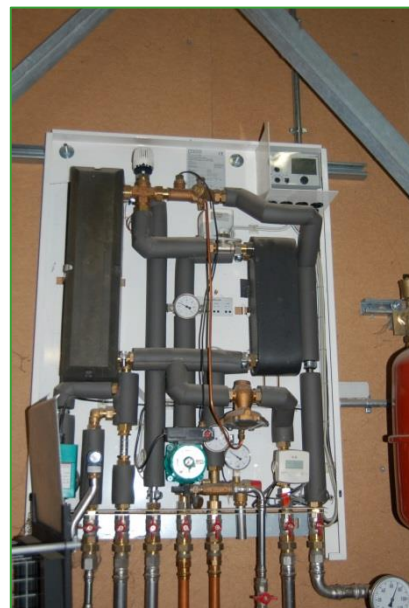
Sous-station de raccordement d'une maison à Beckerich. (© ValBiom)
