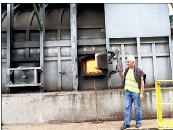
Vues du four biomasse.
