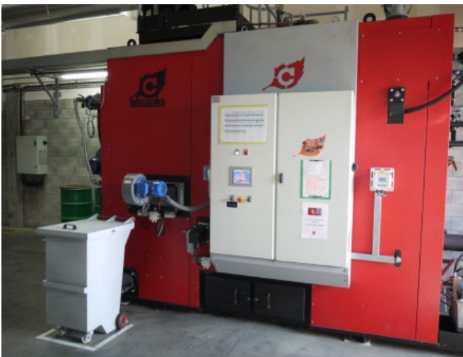
La chaudière « made in France » © La Voix Du Nord.fr
